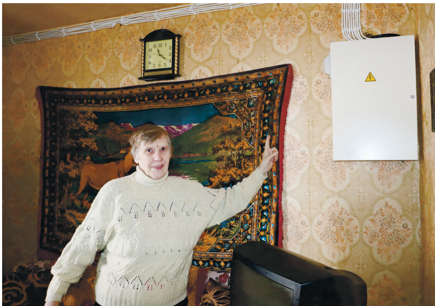
Tiia osutab õnnelikult uue elektrikilbi poole, mis talle taas hingerahu ja valguse majja tõi.
